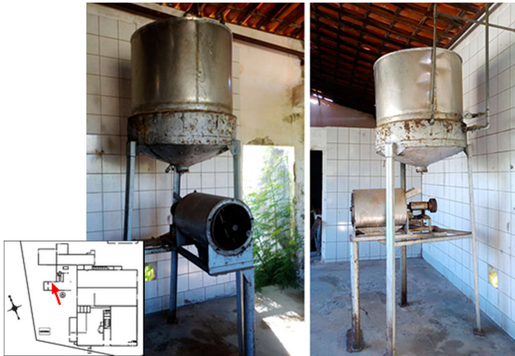
Figura 26 - Tanques de água quente.
